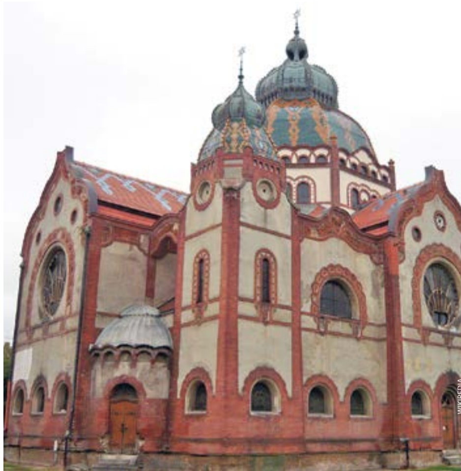
Die Synagoge von Subotica im Norden Serbiens (erbaut 1901-1903 in der Zeit von Österreich-Ungarn) in sehr heruntergekommenem Zustand im Jahr 2012. Das riesige Jugendstilgebäude ist die zweitgrößte Synagoge Europas nach der Großen Synagoge von Budapest in Ungarn. Sie wurde zwischen 2014 und 2018 renoviert.
